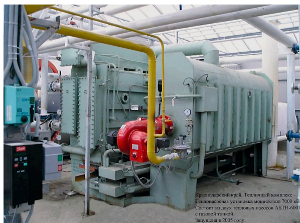
Рис. 5. Теплонасосная установка мощностью 7000 кВт, состоящая из двух тепловых насосов АБХМ-600Т с газовой топкой. Тепличный комплекс, Краснодарский край.
