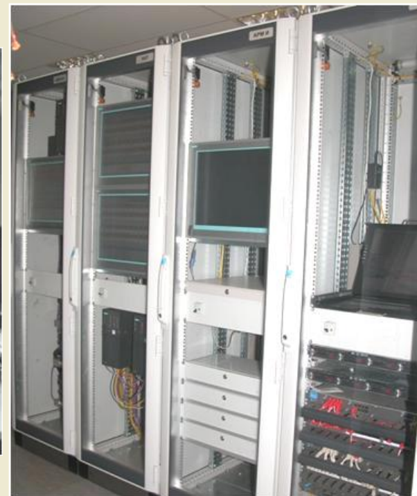
Вид одной из секций с оборудованием (всего в АСУ более 20 различных секций)
