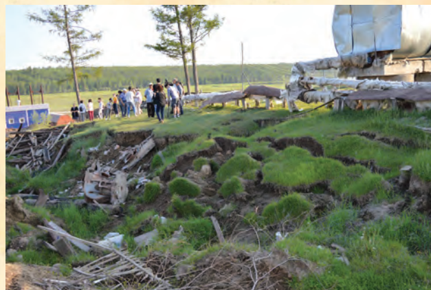
В зону разрушения оврага попадают важные объекты инфраструктуры села. Справа видна ёмкость для хранения аварийного топлива для сельской котельной
